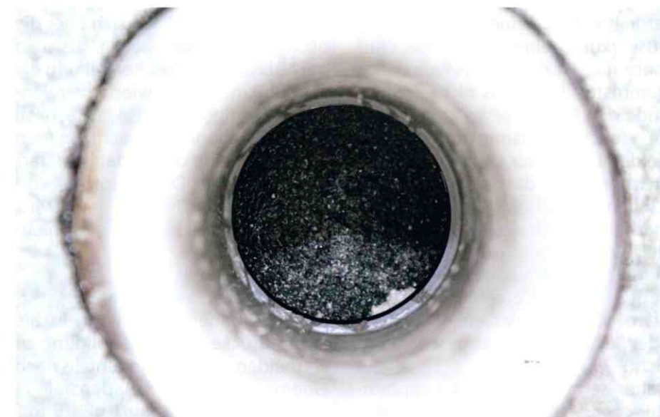
Ein verbliebener Feuchtigkeitsfilm auf der Dampfsperre muss von alleine austrocknen.
