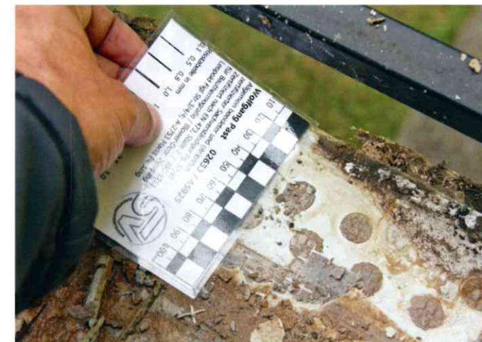
Die völlig abgelöste Streichabdichtung vom Aluwinkel an der Balkontraufe.
