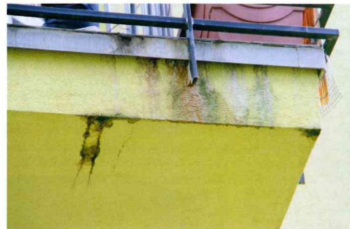
Hier sehr deutlich zu sehen: Die Verfleckungen an der Balkonunterseite.
