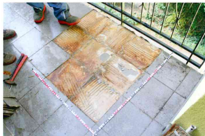
Der zerstörte Kleber unter dem keramischen Belag und die armierte Streichabdichtung.
